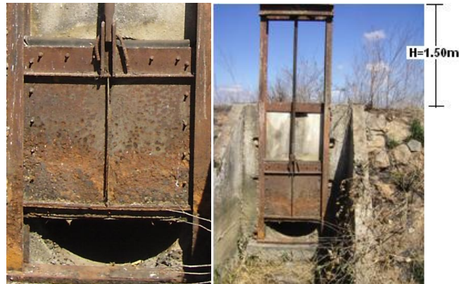
Figura 3. Tapa de compuerta y marco para toma de de agua.
